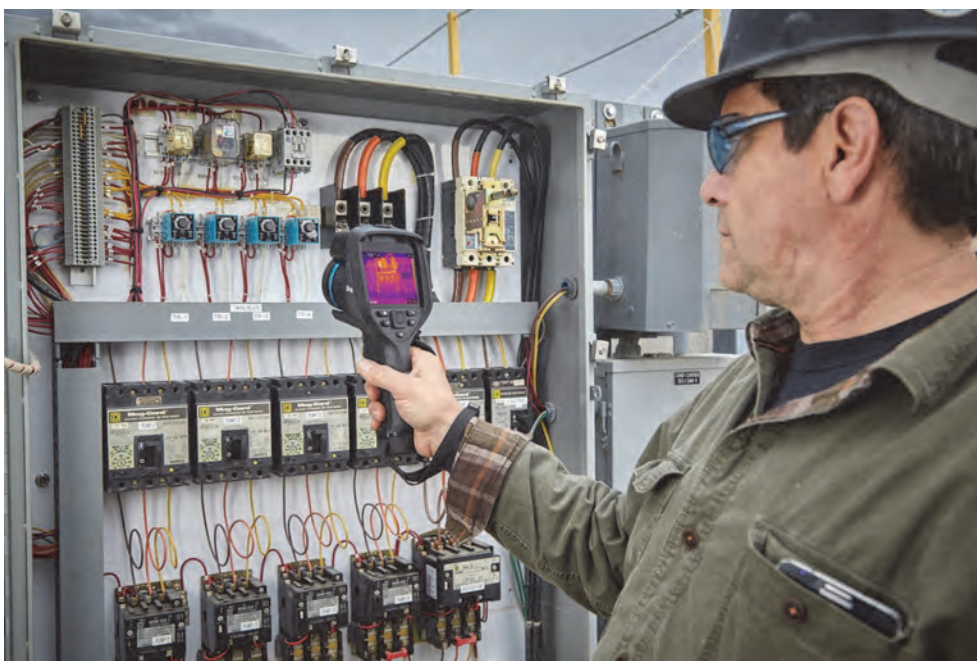
Obr.3 Ruční termokamera FLIR E86 při kontrole rozváděče [1]
