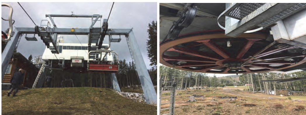
Obr.1 Část pro pohon lanovky a lanovnice lanové dráhy
