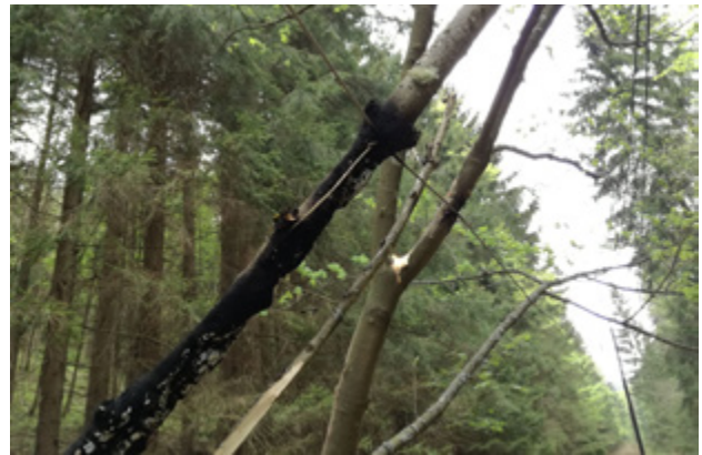
Obrázek 3: Selhání izolace po pádu stromu do vedení
