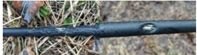
Obrázek 2: Poškození izolovaných závěsných vodičů
