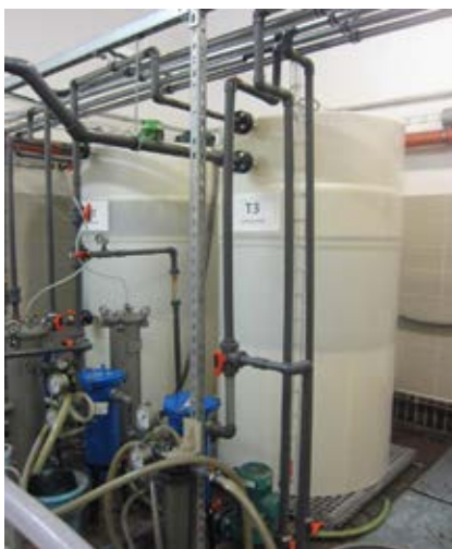
Obrázek 4a: Částečný pohled na recyklační zařízení po navýšení jeho kapacity
