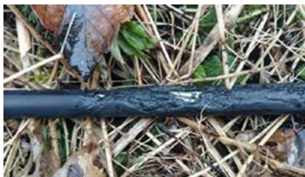
Obr. 2 Poškozený izolační systém CC v důsledku činnosti PD
