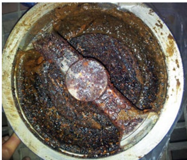
Obr. 1 Zkorodovaná část přepouštěcí klapky sekundárního okruhu teplosměnného systému.
