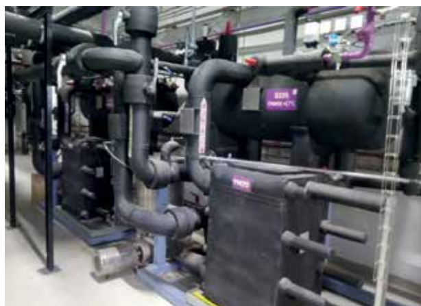
Příklad chladicí technologie z potravinářského provozu výroby sýrů
