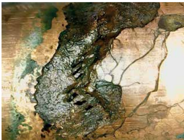
Detailní pohled na zkorodovanou měděnou trubičku výměníku chlazení zimního stadionu po setkání s amoniakem
